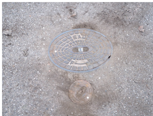
Photo de la bouche d'incendie
