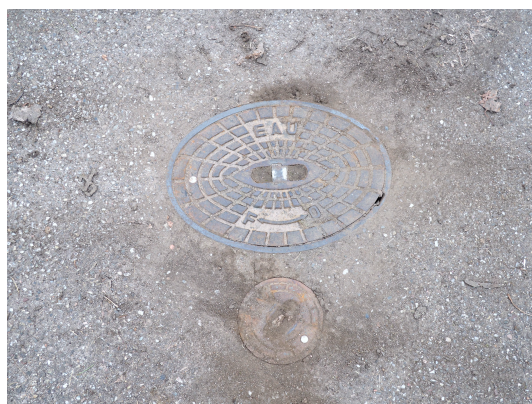
Photo de la bouche d'incendie
